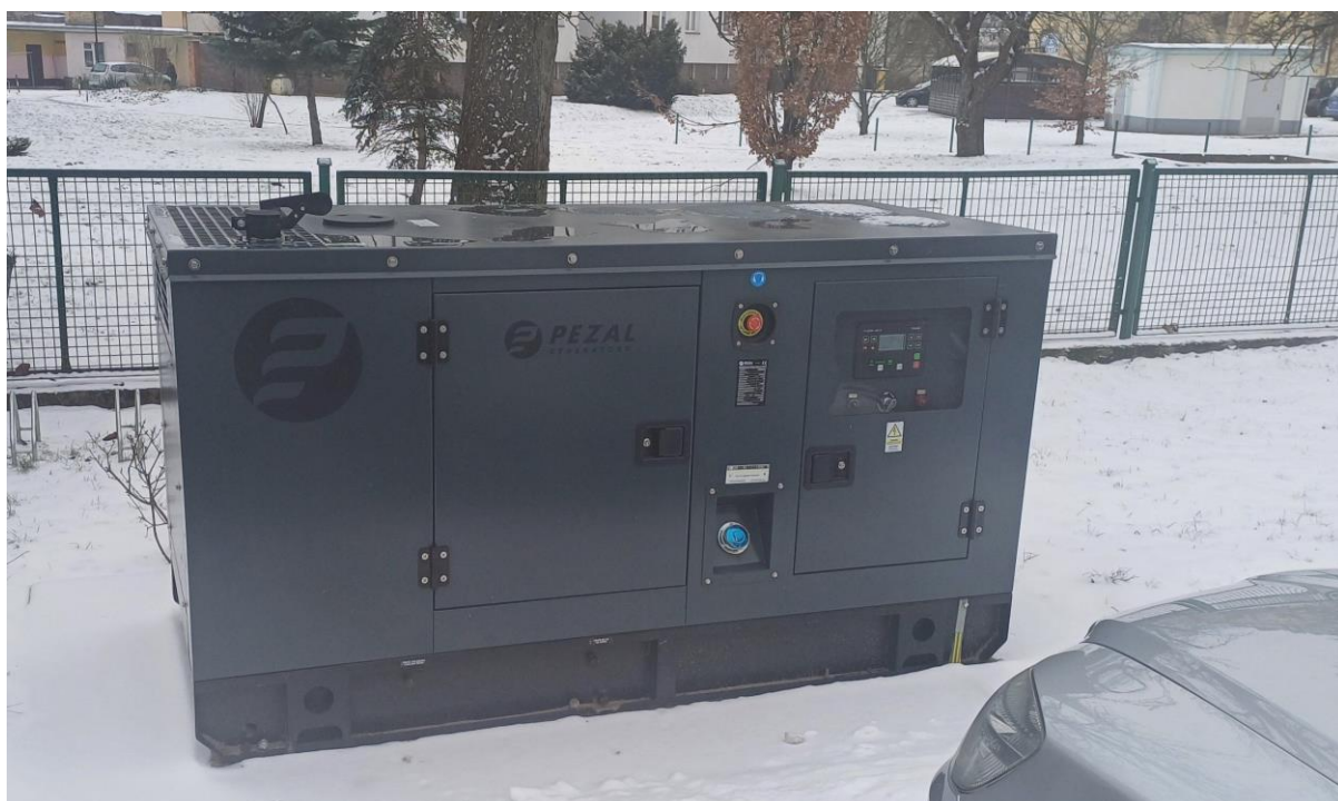
Zdjęcie 37. Agregat prądotwórczy
